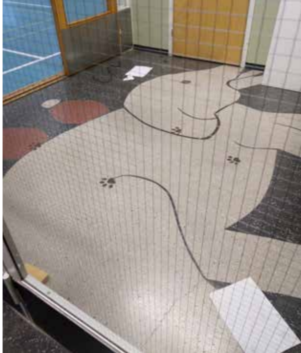
Kuva 46. Ahtaaseen tilaan joutunut mosaikkibetoninorsu rautalankalasin läpi.
