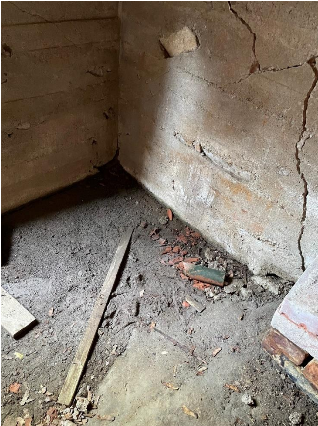
Sisäpuolen halkeama ja kalliopinta
