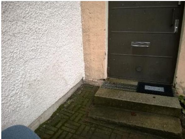
Kuva 6: Umpinainen metallinen ulko-ovi.
