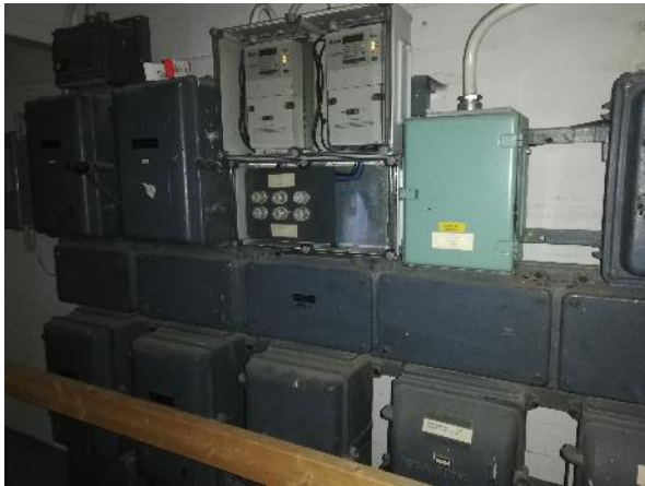
Kuva 38: Rakennuksen sähköpääkeskus sijaitsee toisessa kellarikerroksessa.
