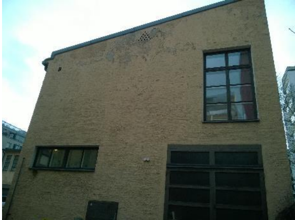
Kuva 20: Pohjoissiiven rapautunutta julkisivua.
