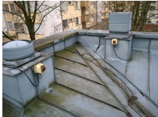
Kuva 37: Poistoilman huippumureita vesikatolla.
