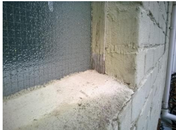
Kuva 9: Takapihalla on rautalankalasisitetuja ikkunoita, joissa ei ole erillisiä vesipellityksiä. Karmirakenteet seinärakenteen sisässä.
