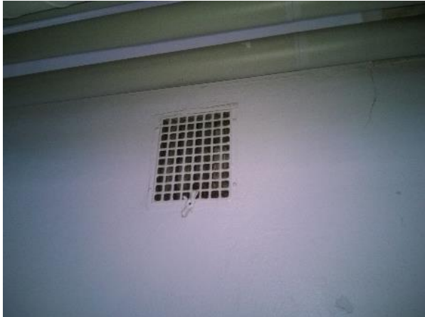
Kuva 34: Painovoimaisen poistoilmahormin venttiili.
