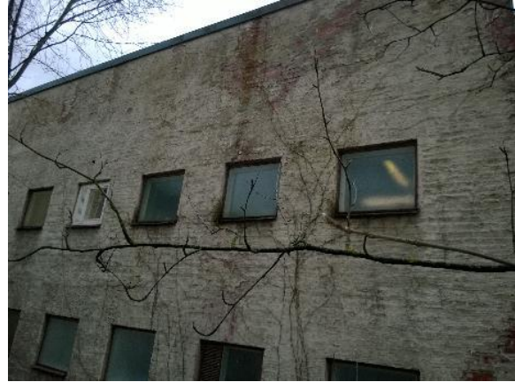
Kuva 21: Itäisen julkisivun rapautunutta ulkoseinää.
