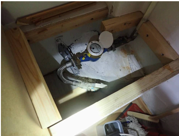
71. Kiinteistön päävesimittari. Tonttivesijohto uusittua muoviputkea.
