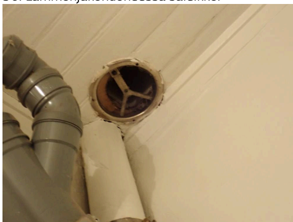
98. Keskimmäisen kerroksen wc:n lautasventtiili puuttuu.
