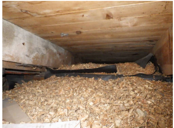
20. Välipohjassa on eristeenä purua.
