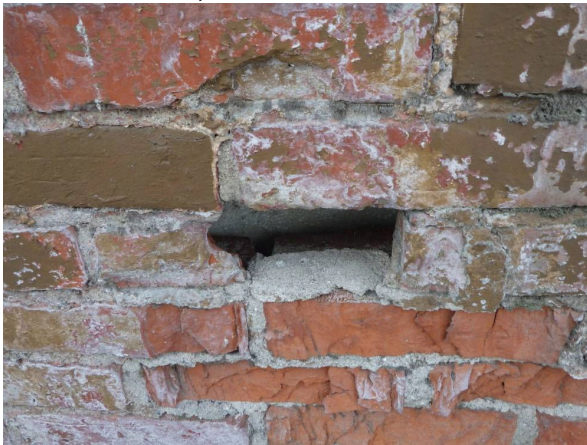
17. Perusmuurin tiilipinnassa on vaurioita
