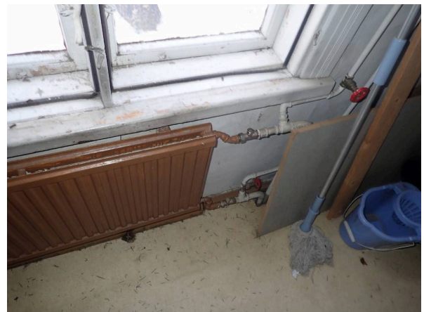
65. Patteriventtiilit ovat uusittuja.
