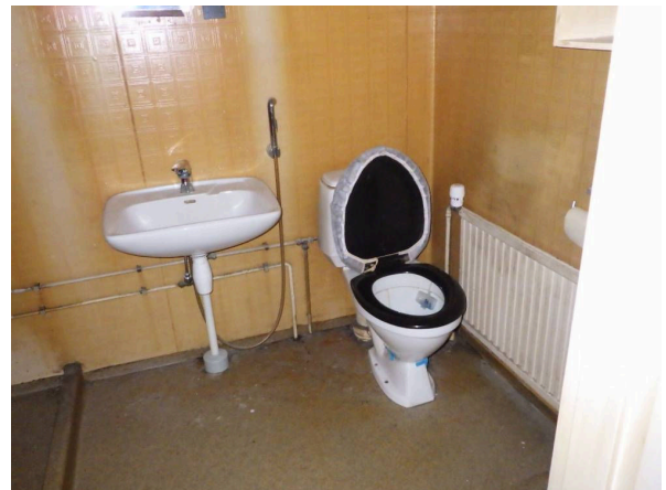
52. Yläkerran pesutilan on huonossa kunnossa.
