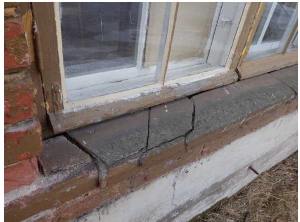
26. Alaikkunoissa ei ole erillistä vesipeltiä ja pinnoite on vaurioitunut
