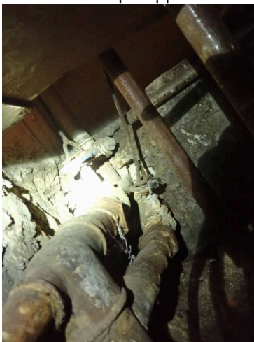
61. Haaralinjoissa vanhoja vinoistukkaventtiilejä.
