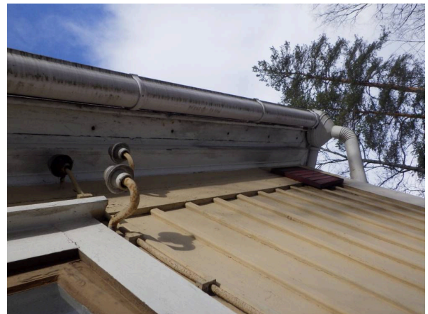
40. Rästäs rakenteiden maalipinta on tummunut ja kulunut.
