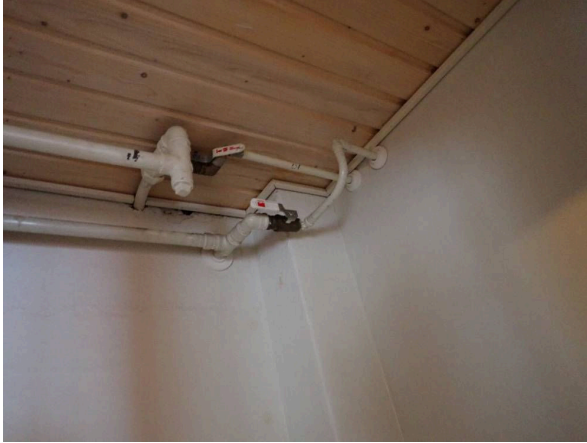
87. Vesijohtoja ilman eristeitä kellaritiloissa.
