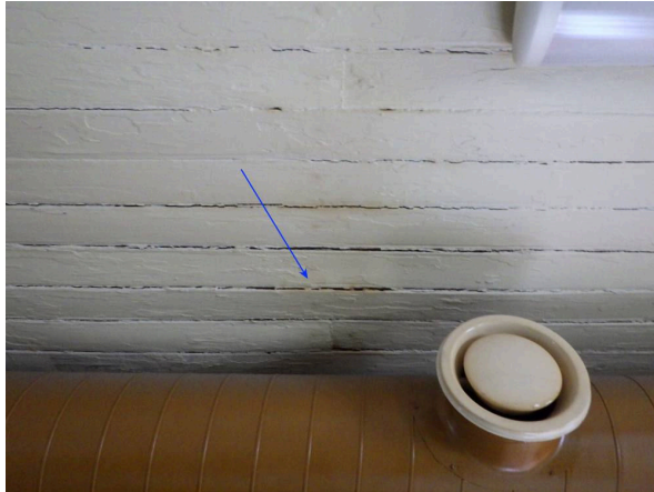
2. 1 kerroksen katossa on kosteusvaurioon viittaava jälki
