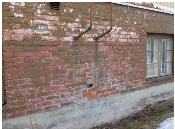
22. Tiilipinnassa on vaurioita
