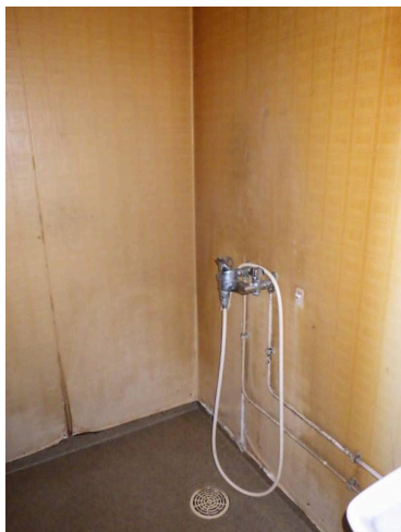
53. Yläkerran pesutila vaatii peruskorjauksen
