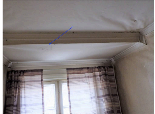
3. Yläkerran katossa on kosteusvaurioon viittaava jälki
