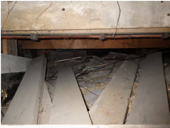
19. Välipohjassa on ylimääräistä tavaraa.
