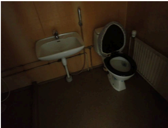
84. Yläkerran vesi- ja viemärikalusteita.
