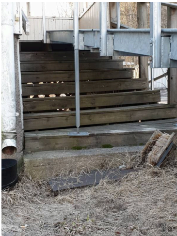
14. Sisäänkäynti portaiden päälle on asennettu luiska. Sisäänkäyntiportaatta ovat huonossa kunnossa.
