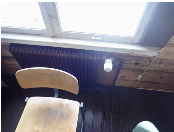
64. Patteriventtiilit ovat uusittuja.
