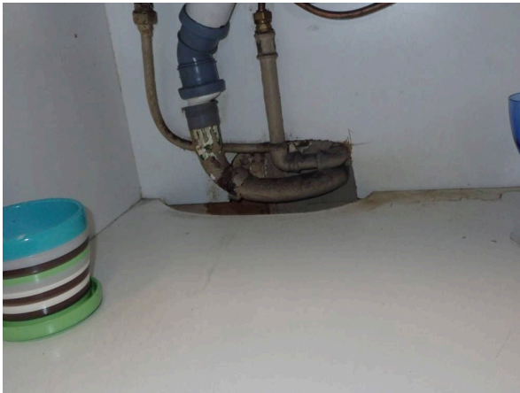
73. Keskimmäisessä kerroksessa kylmävesijohto tulee sinkityllä teräsputkella vesikalusteelle asti.
