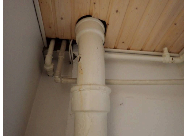
79. Viemärit ovat valurautaa. Oletettavasti 60-luvulta.
