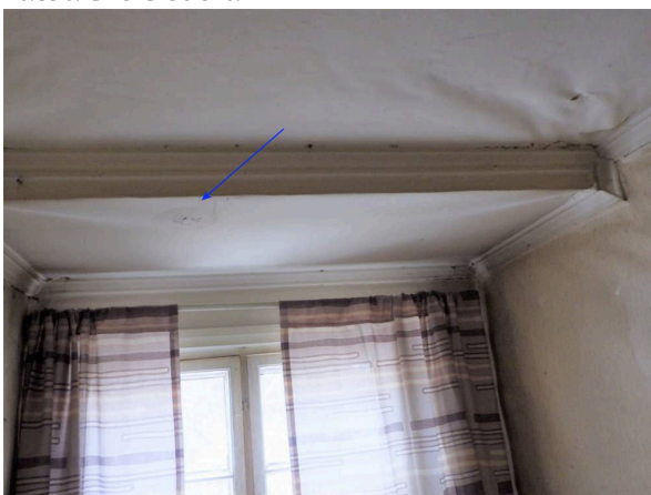
47. Yläkerran katossa on havaittavissa kosteusvaurion aiheuttamia jälkiä.
