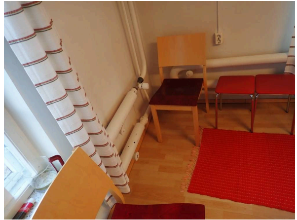
67. Kellarin tiloissa on putkipattereita.
