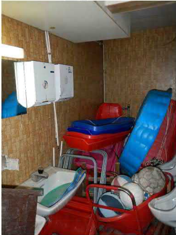
Osa rukoushuoneen märkätiloista on huonossa kunnossa.
