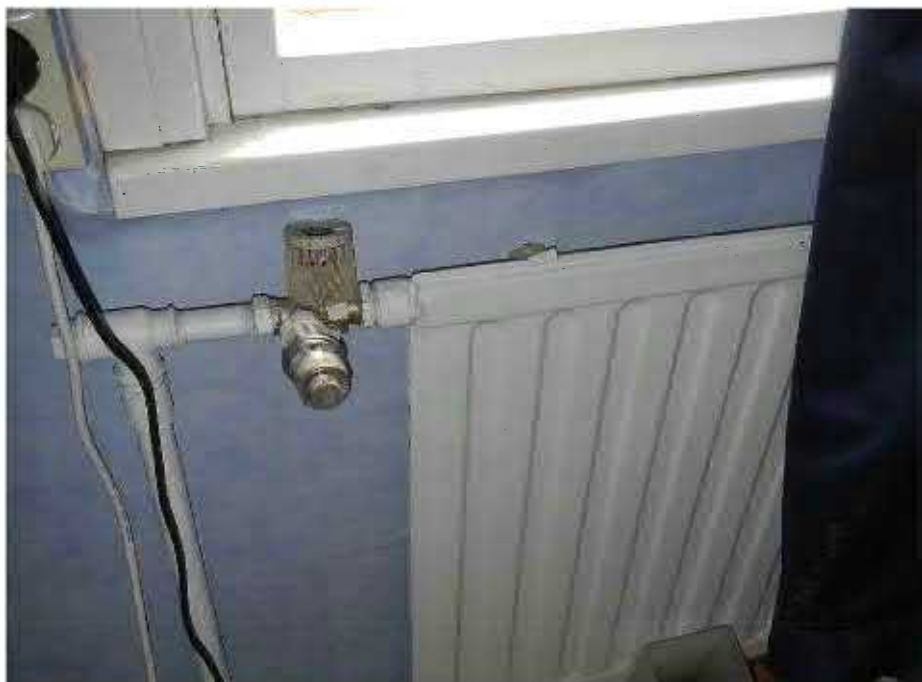
Omakotitalon patteriventtiilit ovat osittain teknisen käyttöään lopussa.
