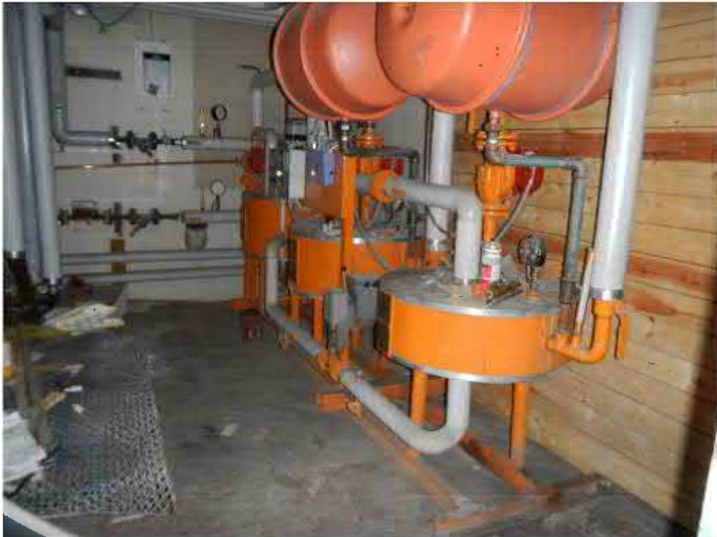
Rukoushuonetta ja omakotitaloa palvelevat lämmönsiirtimet ovat teknisen käyttöön lopussa.
