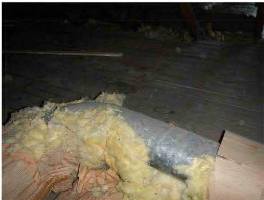
Rukoushuoneen ullakolla IV-kanavien eristys on puutteellinen.
