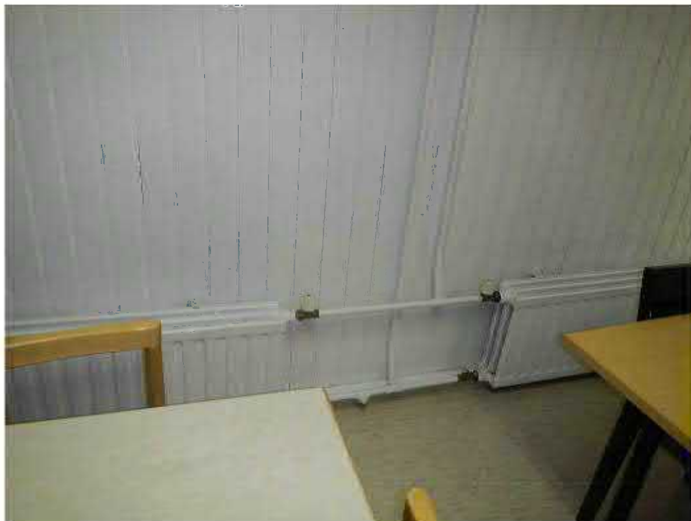
Rukoushuoneen patteriventtiilit ovat osittain käsisäätöventtiileitä.
