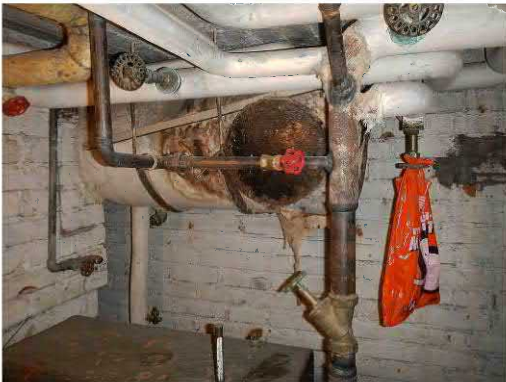
Omakotitalon kellarissa on rikkiäistä asbestieristettä.
