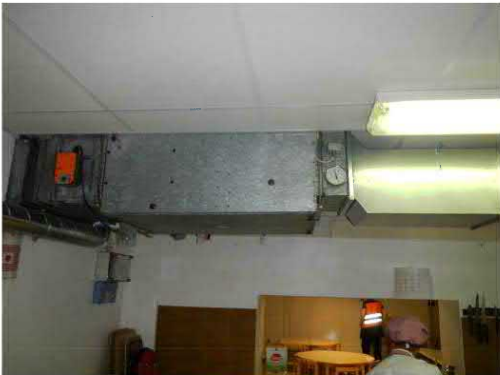
Rukoushuoneen keittiön tuloilmakone on teknisen käyttöään lopussa.
