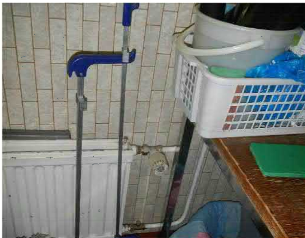
Rukoushuoneen patteriventtiilit ovat osittain teknisen käyttöään lopussa.
