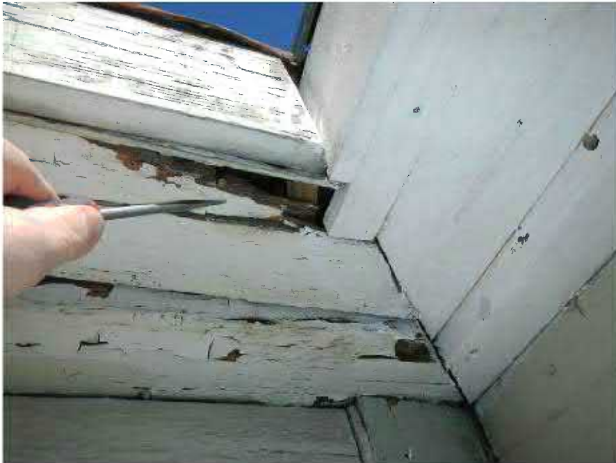
Rukoushuoneen räystäässä on havaittavissa pieniä lahoalueita.
