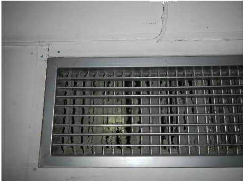
Rukoushuoneen ilmanvaihdon päätelaitteet ovat likaiset.
