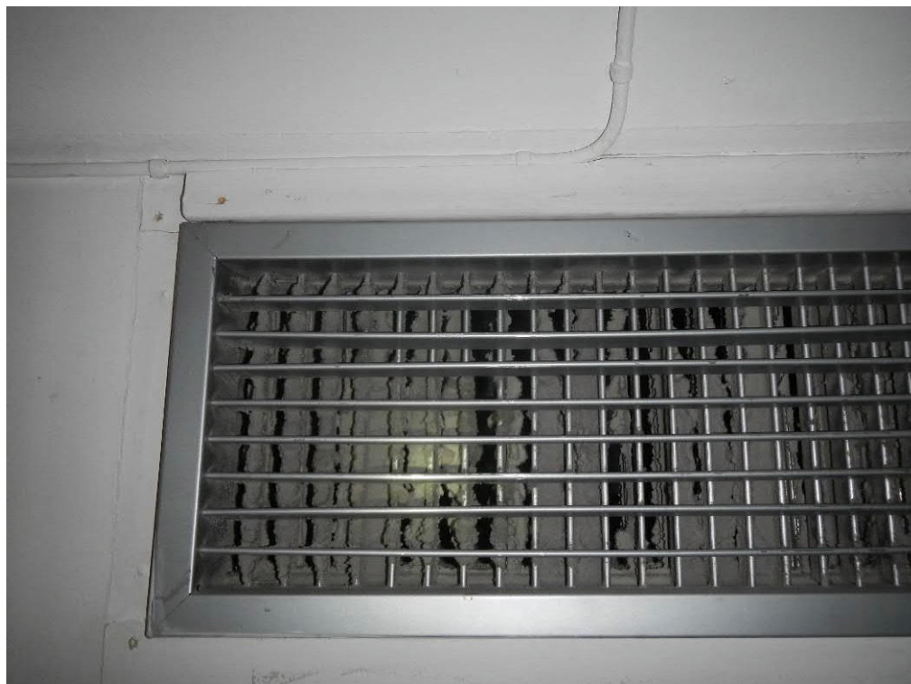
Rukoushuoneen ilmanvaihdon päätelaitteet ovat likaiset.
