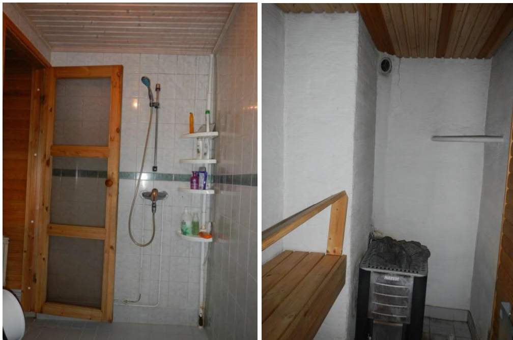
Omakotitalon saunan suihkutila ja löylyhuone ovat huonossa kunnossa. Löylyhuoneen seinän yläosassa on halkeama.
