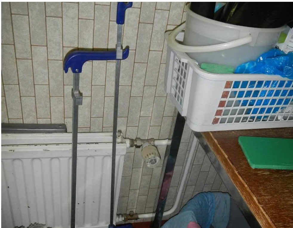
Rukoushuoneen patteriventtiilit ovat osittain teknisen käyttöään lopussa.
