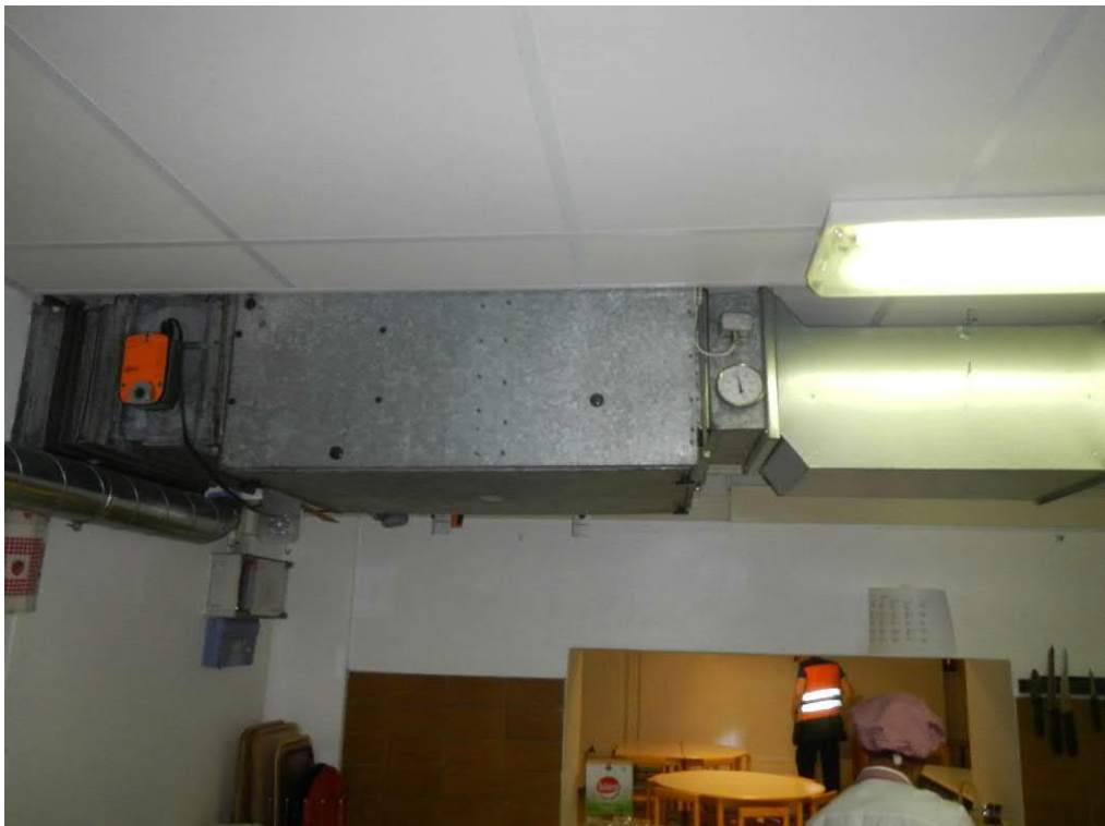
Rukoushuoneen keittiön tuloilmakone on teknisen käyttöään lopussa.
