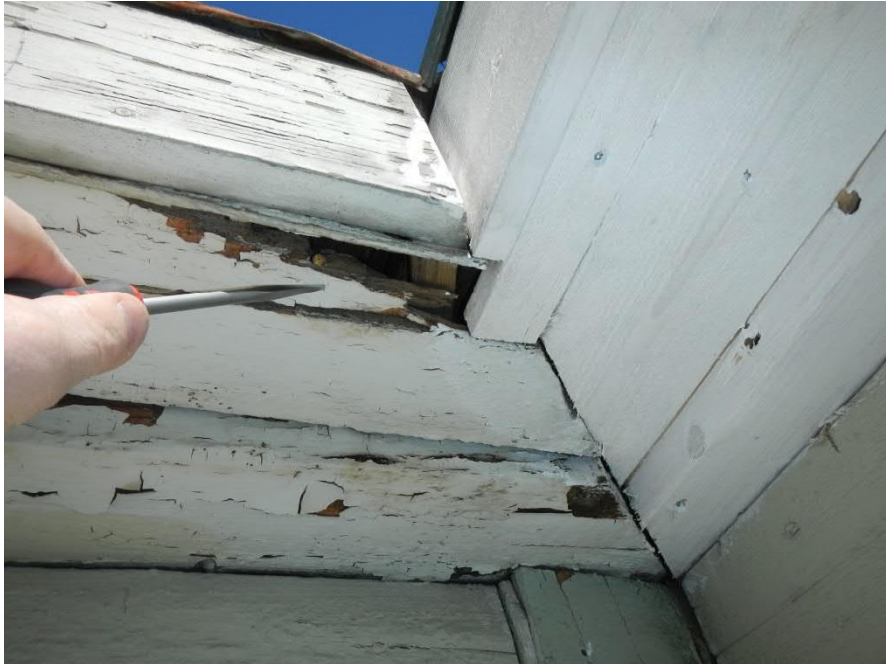
Rukoushuoneen räystäässä on havaittavissa pieniä lahoalueita.
