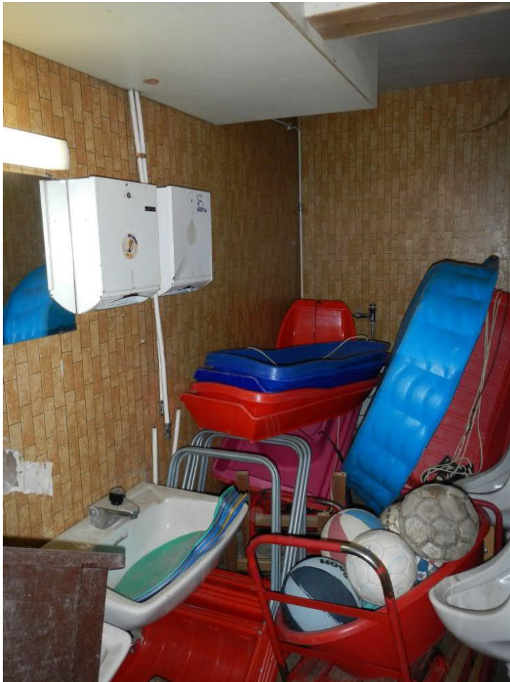
Osa rukoushuoneen märkätiloista on huonossa kunnossa.
