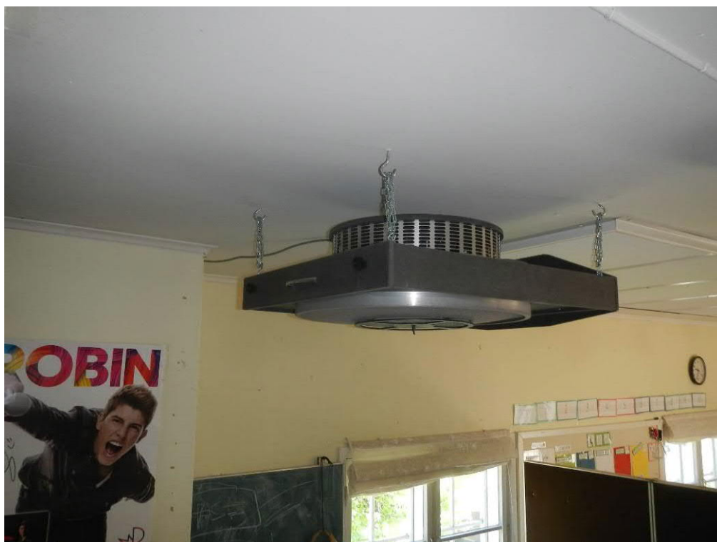
Ilmanpuhdistin päiväkodin tiloissa.
