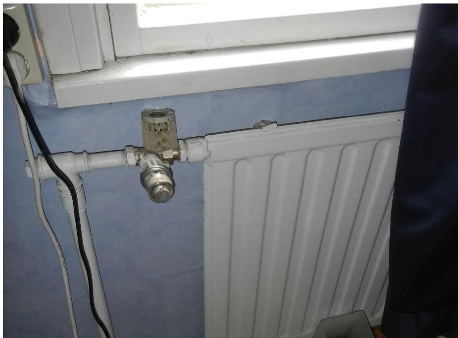
Omakotitalon patteriventtiilit ovat osittain teknisen käyttöään lopussa.
