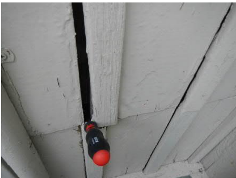
Omakotitalon seinässä on rako, jonka kautta vesi pääsee seinärakenteen sisään.
