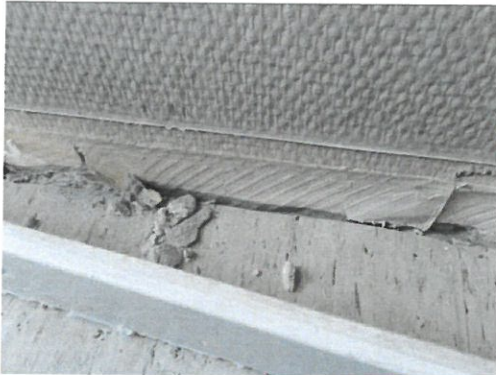
Kuva 4. Ulkoseinän ja lattian rajassa pieniä halkeamia
