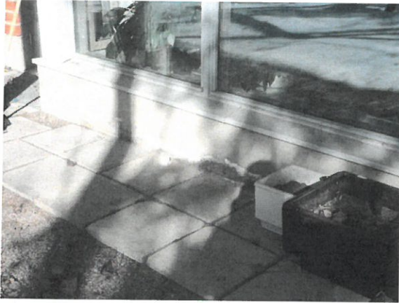
Kuva 6. Kosteuden aiheuttamia jälkiä sokkelissa.
