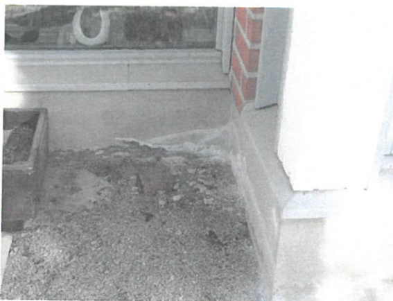
Kuva 8. Kosteuden aiheuttamia vauriojälkiä sokkelissa.
