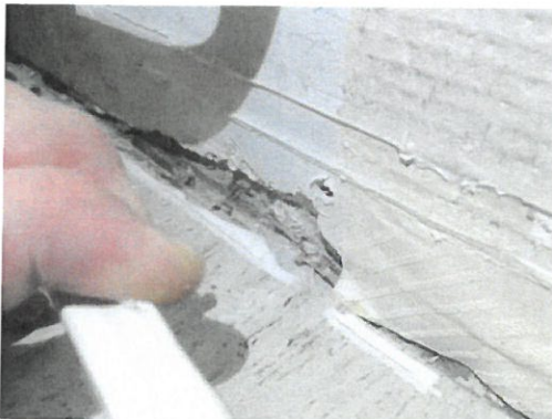
Kuva 5. Ulkoseinän ja lattian rajassa pieniä halkeamia
