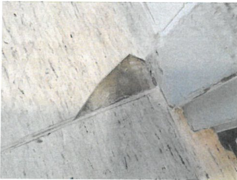
Kuva 1. Lattian muovimaton alla voimakas haju.
