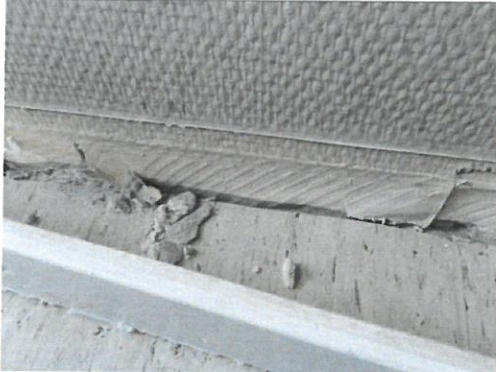
Kuva 4. Ulkoseinän ja lattian rajassa pieniä halkeamia
