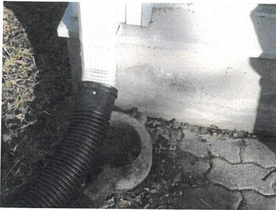
Kuva 7. Roiskevesien aiheuttamia vauriojälkiä sokkelissa.
