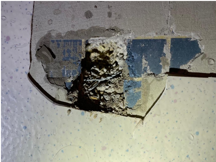
Kuva 5.12 Rakenneporaus ullakon kylpyhuoneen seinään. Seinässä on muovitapetin alla selostuksessa esitetty laatoitus, rappaus verkolla ja tojalaevyeriste. Tojalaevyn käyttö märkätilojen seinissä riskirakenne, seinissä ei ole vesieristettä ja orgaanisella materiaalilla on suuri homeutumisriski.
