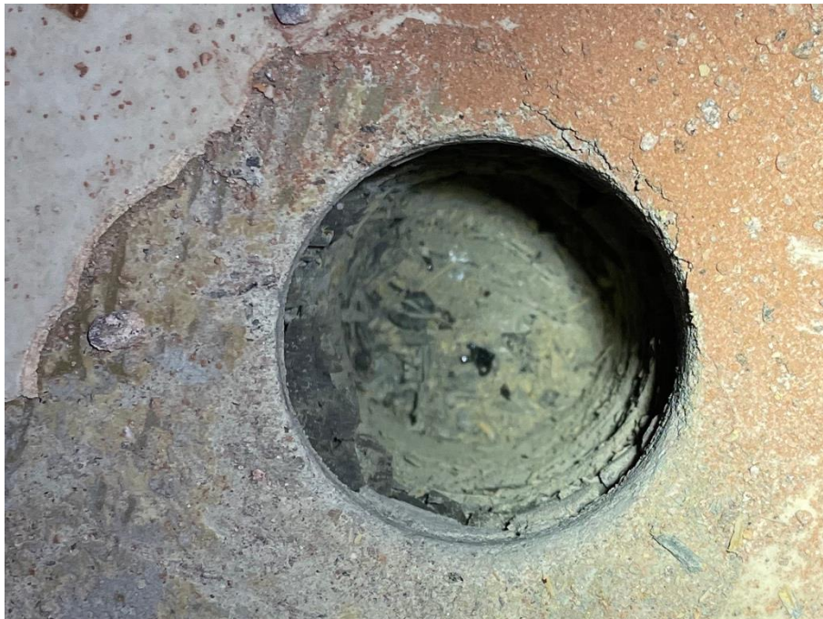
Kuva 5.14 1. kerroksen lattian avaus. Toja-lämmöneristeen alapinnassa on bitumisively ja yläpinnassa bitumipaperi. Bitumipapereista on todettu haitta-aineen raja-arvot ylittäviä pitoisuuksia PAH-yhdisteitä.
