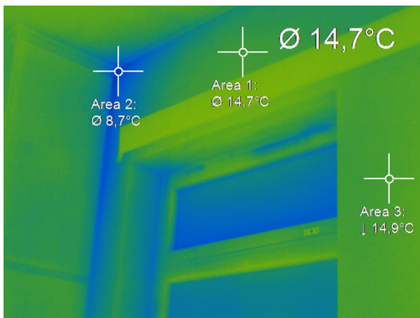
Kuva 5.20 A-talo asunto 3. 1. kerros, keittiö. Ylänurkassa esiintyy kylmempiä lämpötiloja. Kyseisessä kohdassa on ulkoseinässä kiinni olevat täyskorkuiset kaapistot.
