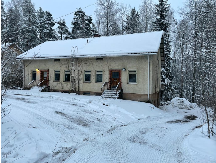
Kuva 5.1 A-talo on paritalo, asunnot ovat 92,5 m 2 kokoisia toistensa peilikuvia. Ulkoseinärakenteena on rapattu tiilirakenteinen sahanpurueristetty seinä. Tiilestä on tehty lokeroita, joiden välissä on sahanpurueriste.
