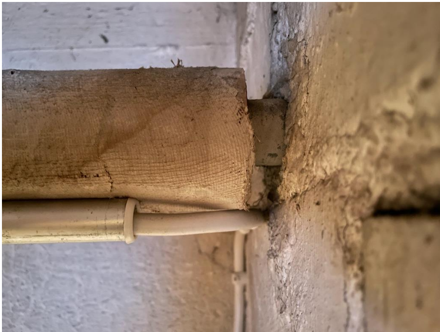
Kuva 5.16 Vesiputkia on asennettu niin, että läpiviennit ovat kiinni betonirakenteissa, rakenteiden mahdollinen siirtymä voi aiheuttaa putkiliitosten vaurioitumista.
