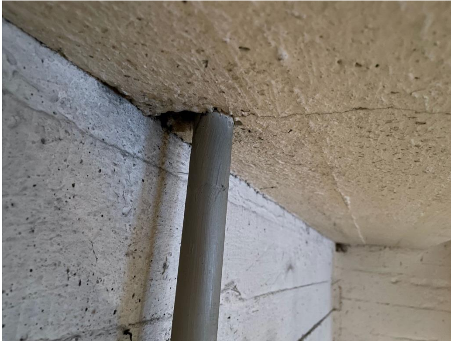
Kuva 5.15 Vesiputkia on asennettu niin, että läpiviennit on kiinni betonirakenteissa, rakenteiden mahdollinen siirtymä voi aiheuttaa putkiliitosten vaurioitumista.
