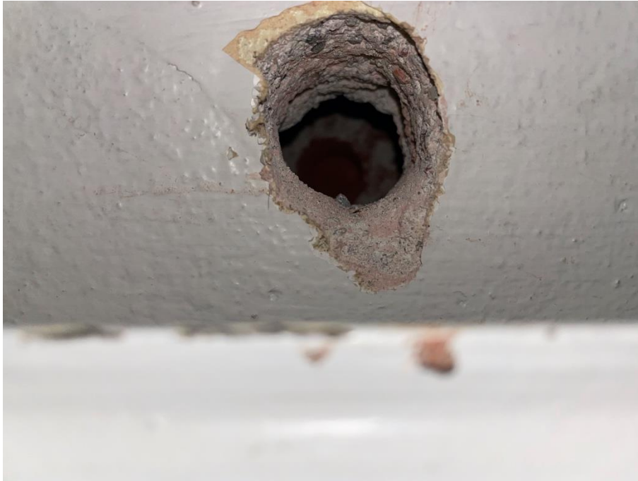
Kuva 5.9 Rakenneporaus ullakon makuuhuoneen ulkoseinään ikkunan alapuolelta. Kyseisessä kohdassa rakenteessa on sisäpinnassa noin 30 mm paksu rappaus, ilmarako ja tiili.
