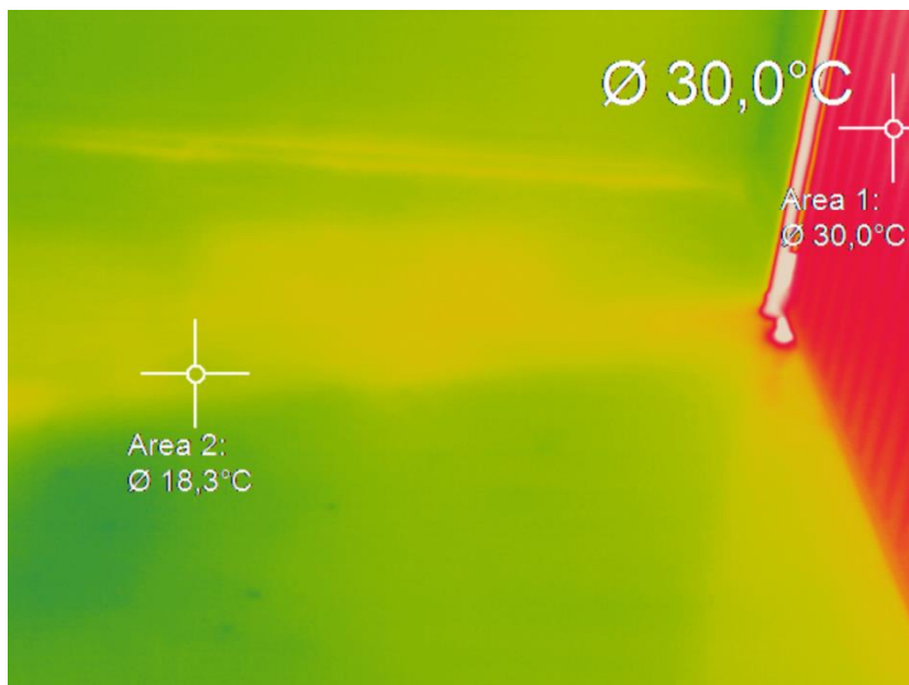
Kuva 5.32 B2-talo asunto 7 Ullakko, Iso makuuhuone. Lämpöpatteri vaikuttaa olevan toiminnassa, lämpöpatterien putket kulkevat poikkeuksellisesti vaakasuoraan välipohjan sisällä. Putkirikko aiheuttaisi lämmöneristeen kastumisen ja on suuri riskitekijä.
